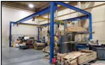
16'W x 25'L x 12'H Bridge Crane
